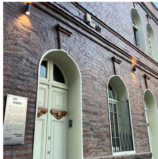
Término de obras conservación de fachadas y áreas comunes del Cité Zenteno, Santiago, Fabiola Contreras Salas, 2022.
